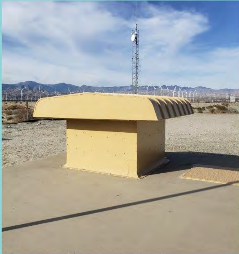
New penthouse fan
